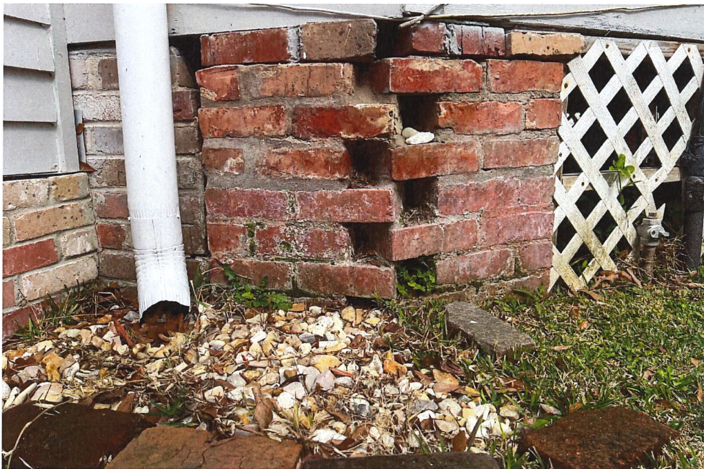
Eroded Pier - SE
